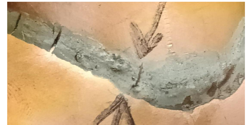
Obr. 3 Příklad trhlin v koutovém pájeném spoji Fig. 3 Example of cracks in a corner brazed joint
