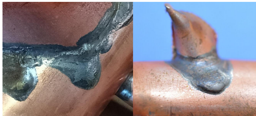
Obr. 8 Nadbytek pájky Fig. 8 Excess solder
